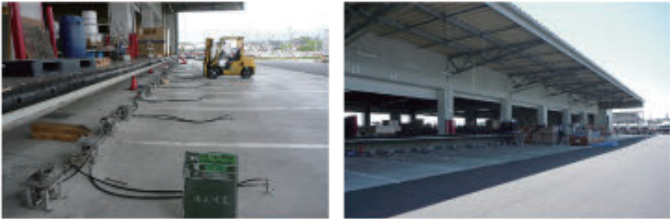
■ 機械基礎と周辺スラブの沈下修正 機械基礎部100mm程度隆起
