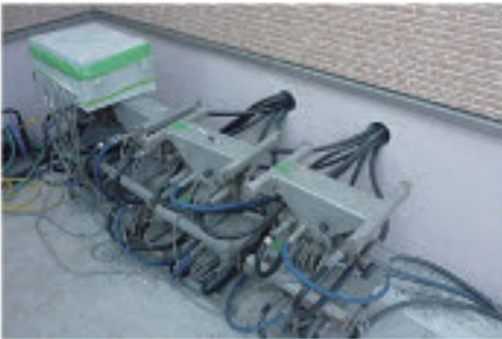
屋外には分岐バルブ装置を設置
